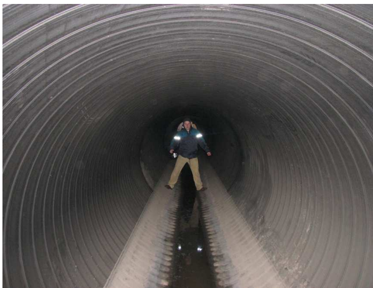
Kanał o średnicy 2 metrów odprowadzający ścieki z miasta do wybudowanej przepompowni ścieków na terenie bazy głównej „Wodociągów Słupsk” przy ul. Orzeszkowej 1.
