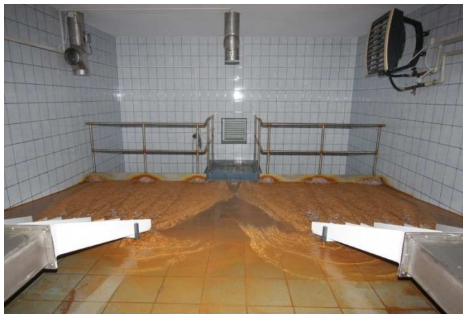
Stacja Uzdatniania Wody - odpływ wody z aeratorów kaskadowych
