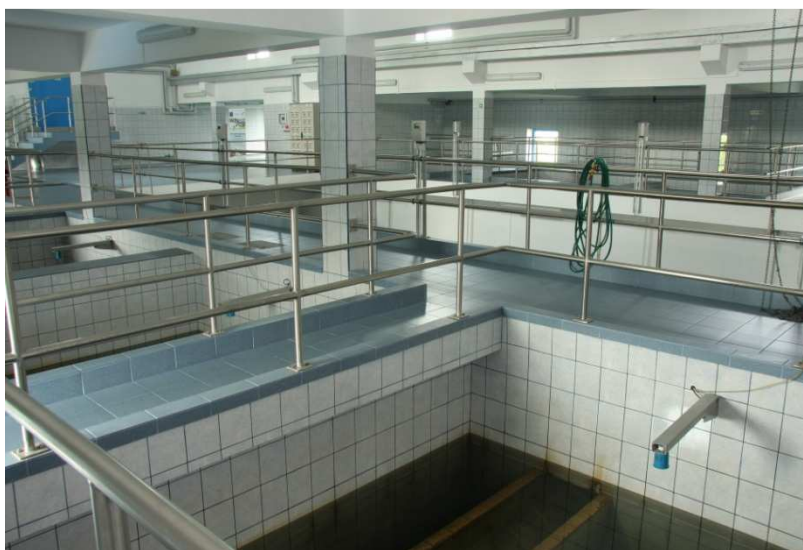
Stacja uzdatniania wody przy ul. Westerplatte w Słupsku
