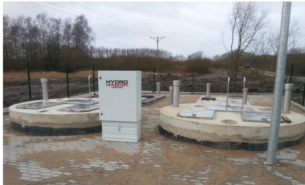
Przepompownia ścieków POS przy oczyszczalni
